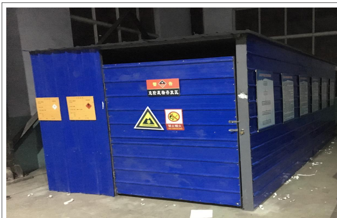
危废暂存间图 4-2
